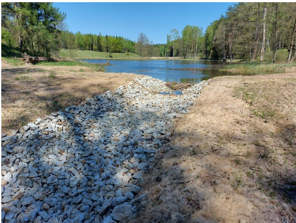
Fot. 5 Nadleśnictwo Złotów - Stebionek wlot do bystrotoku i staw dolny
